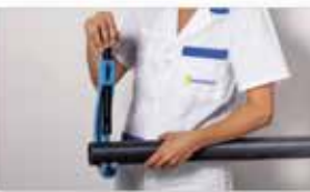
Cortar el tubo con los tronzadores.
